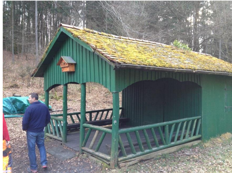
Die baufällige Hütte im Frühjahr 2014.
